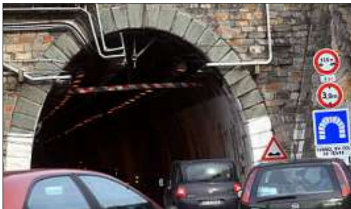
En raison d'infiltrations d'eau côté italien, le tunnel est resté fermé quatre jours.
